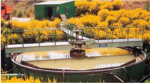
Sistema de bombeo para agua clarificada – Explotación El Porcal – Aripresa – España
