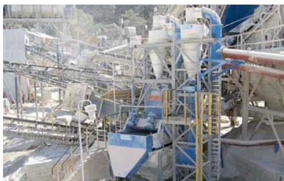
Integración de dos hidrociclones para los procesos de lavado y clasificación en una explotación
