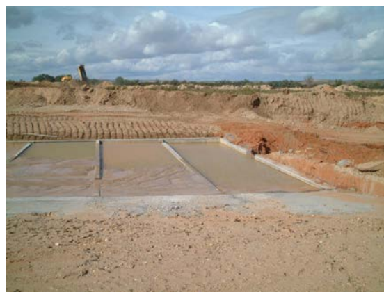
Balsas de hormigón para lodos – Explotación de arena y grava – FdA – España
