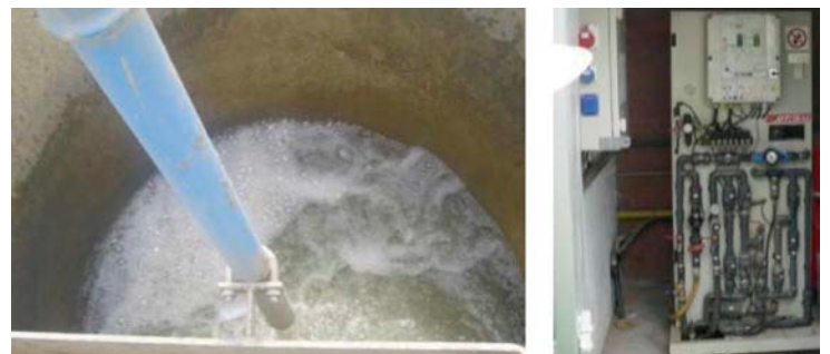
Instalación de dosificación de floculantes - Gravera - Varias empresas - España
